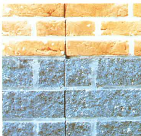
Foto 1 Dit is een foute oplossing.
